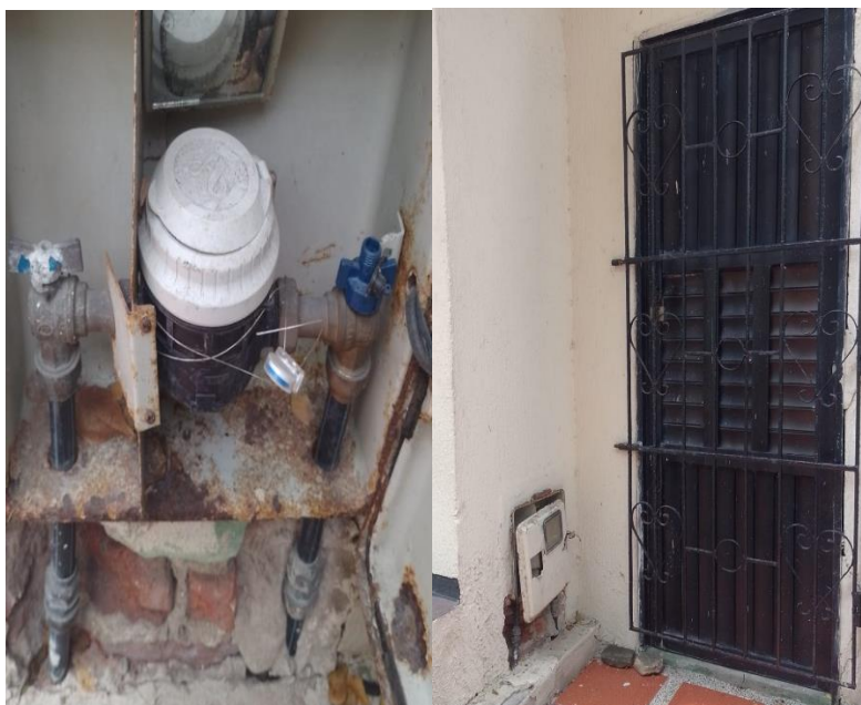
Figura No.4 Control principal de la red hidráulica de la sede administrativa 2.
