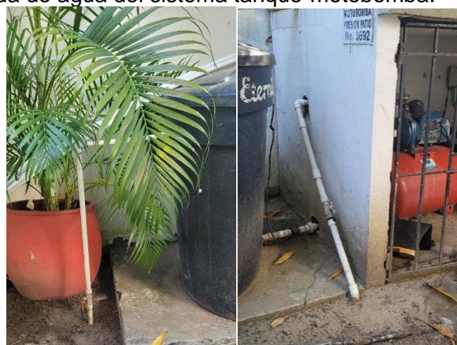
Figura No.2 Control de ingreso y salida de agua del sistema tanque-motobomba ubicado en el patio-comedor de la sede principal
