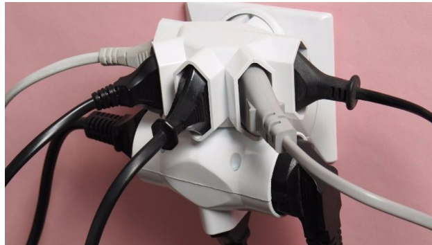
Figura No.2 Ejemplo toma corriente sobrecargado 3
