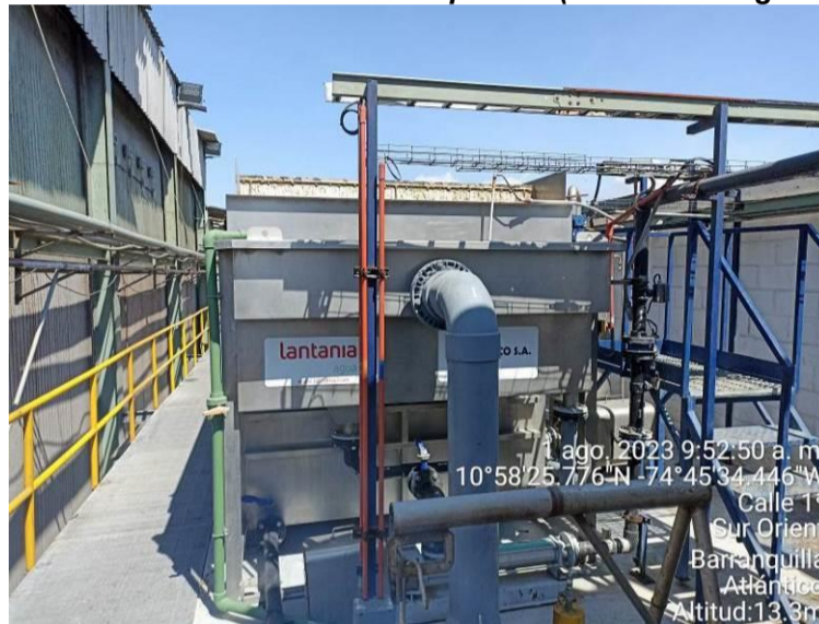
Fotografía No. 2 – Detalle del tratamiento físico-químico (DAF-300: coagulación, floculación).
