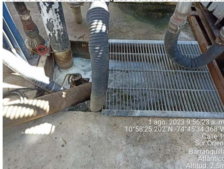
Fotografía No. 3 – Detalle de la Salida de las Aguas residuales tratadas hacia el Río Magdalena.
