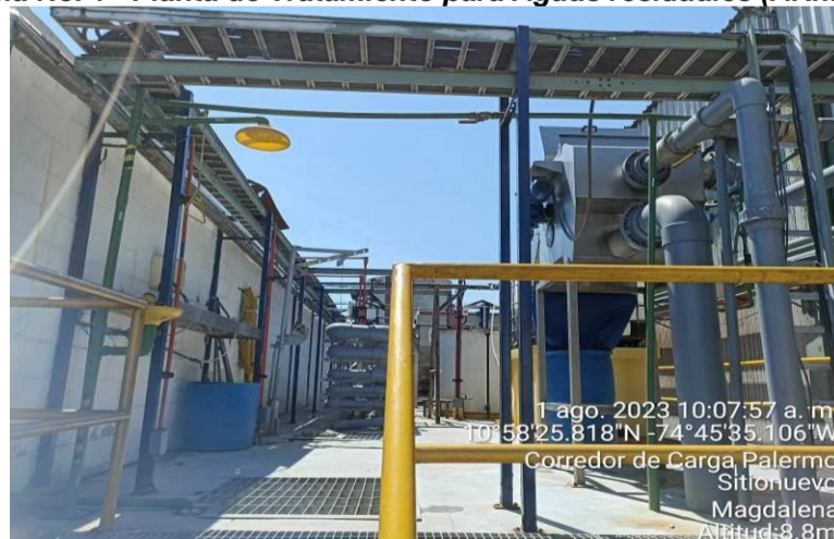
Fotografía No. 1 –Planta de Tratamiento para Aguas residuales (ARnD Y ARD).
