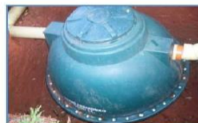
Figura 4. Filtro Anaerobio en sitio.
