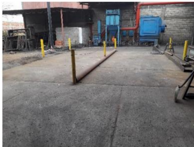
Foto 2 Instalación de extractor N°. 2 (actualmente fuera de servicio) Zona de granalla
