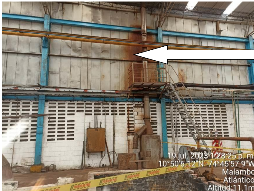
Fotografía No. 1 – Chimenea del -Horno de ZINCADO atravesando el techo y con su respectiva plataforma de monitoreo
