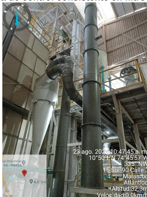
Fotografía No. 2 – Fuente fija#2: Ensacado de harina de trigo (Sistema neumático), con sistema de control consistente en filtro de mangas.
