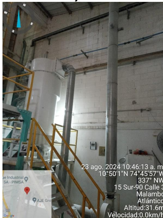
Fotografía No. 1 – Ciclón Fuente fija#1: Sistema de limpieza de trigo 1-2.
