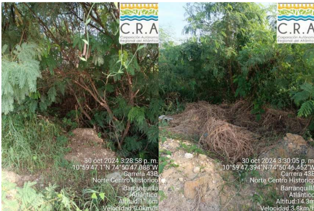
Fotografías No. 12 y 13 – Inadecuada disposición de residuos RCD en zona con cobertura vegetal., C.R.A (2024).
