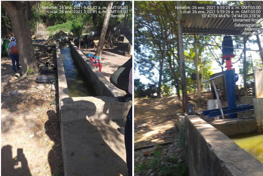
Imágenes de motobomba de captación y canal de distribución
