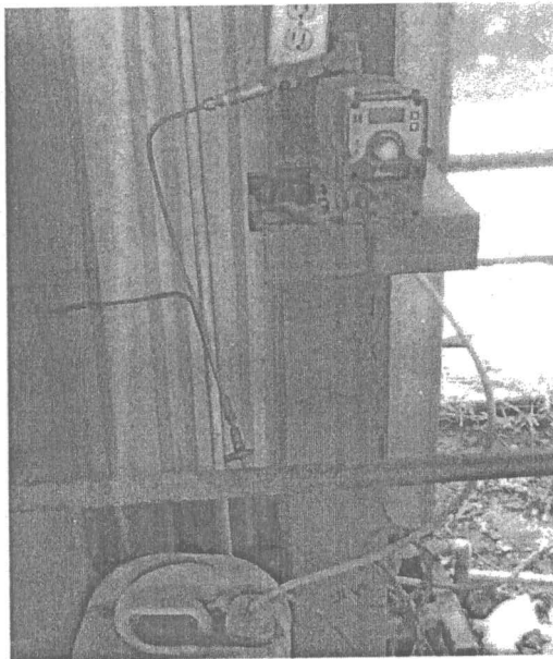
Foto 5. Dosificador de resina para el ablandamiento de aguas de caldera.
