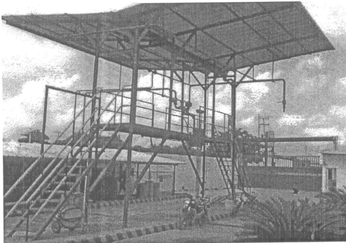
Foto 2. Área para el despacho de productos líquidos.
