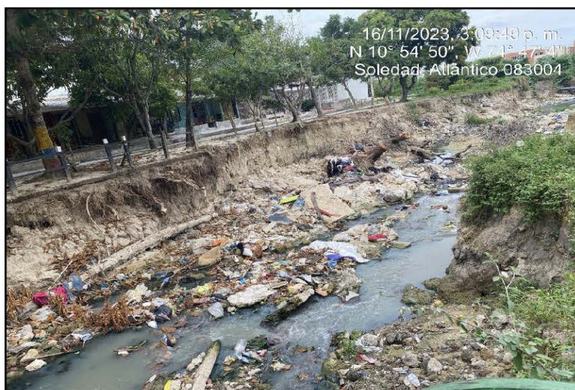
FOTO 2. EROSIÓN DEL ARROYO VILLEGAS.
