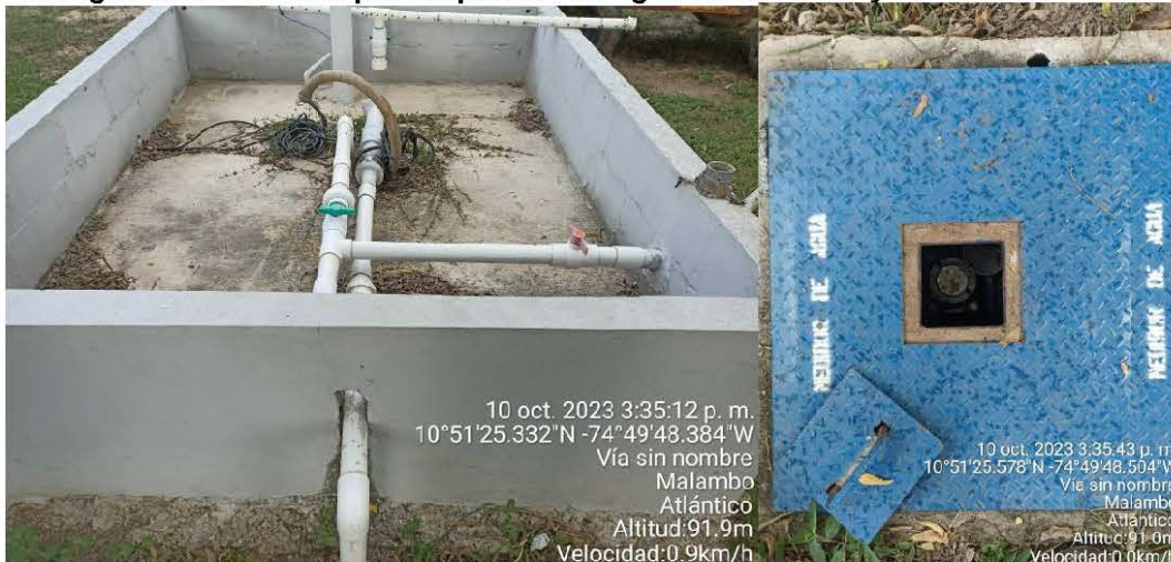
Fotografía No. 2 –Pozo para captación de agua subterránea y Medidor de caudal.
