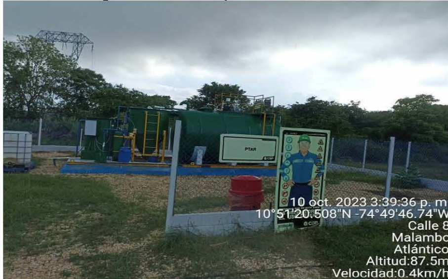
Fotografía No. 1 –PTAR para tratamiento de ARD.
