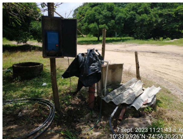
Foto 25. Punto de captación de aguas subterráneas.
