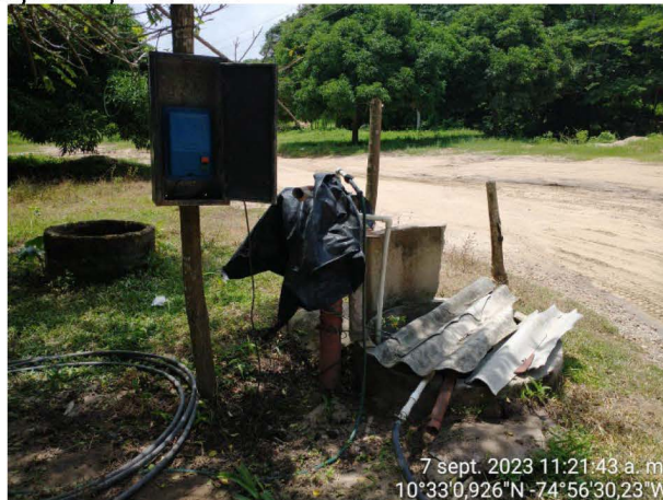
Foto 25. Punto de captación de aguas subterráneas.
