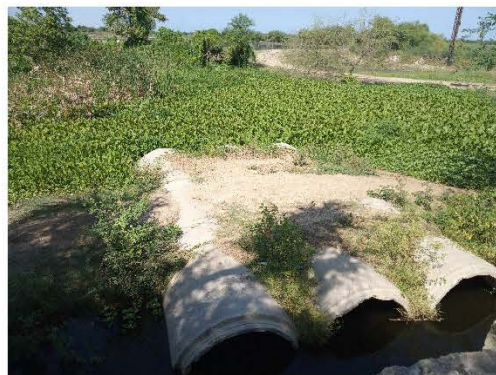
Foto 2. Acceso a lagunas de oxidación. Área inundada.
