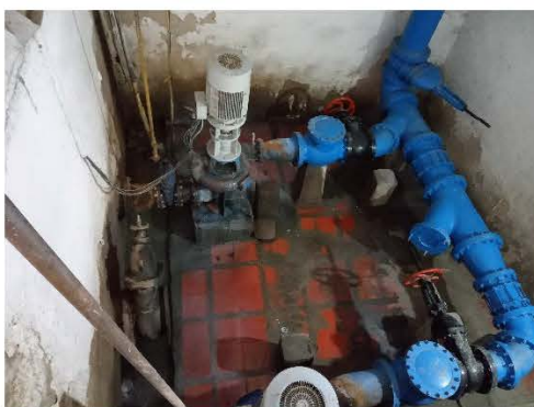
Foto 5. Cuarto de bombas EBAR
