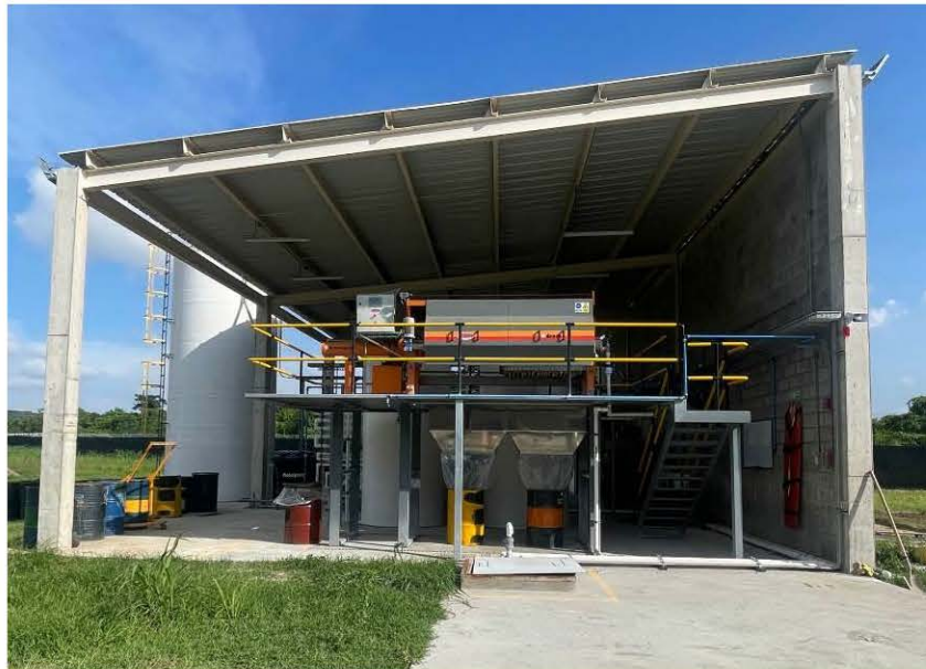
Fotografía No. 2 – Planta de Tratamiento para aguas residuales no domesticas -PTAR
