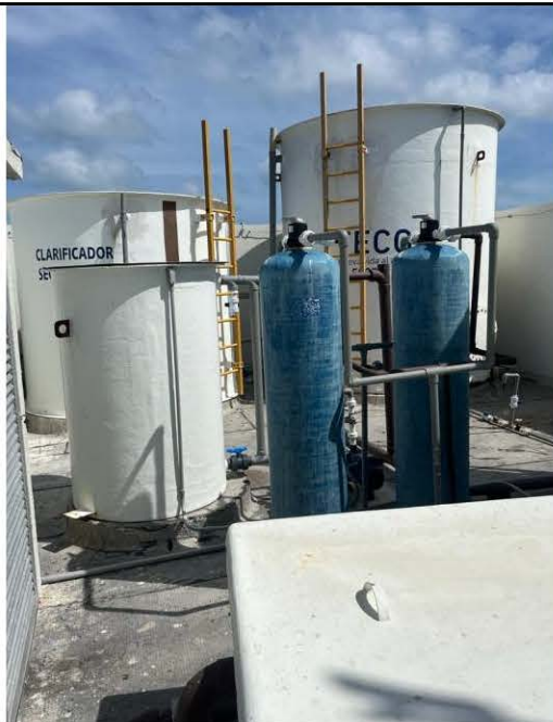
Foto N.º 2 Fecha: 23 de octubre de 2023. Ubicación: Conjunto Residencial Puntamar Observaciones: planta de tratamiento de agua residual en azotea
