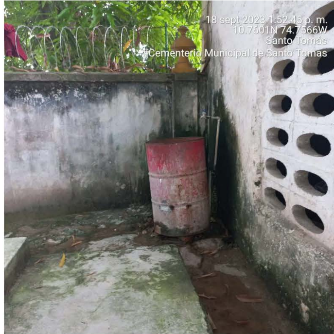
Foto 3 Grifó y tanque donde se recolecta el agua suministrada por la triple A
