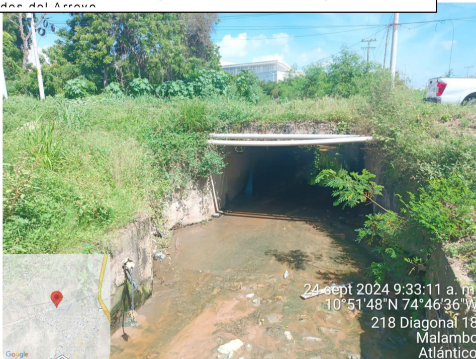
Foto N° 4 Fecha: 24 de septiembre del 2024. Ubicación: Diagonal 18 Malambo Atlántico Observaciones: Tramo final canalización arroyo el Sapo.
