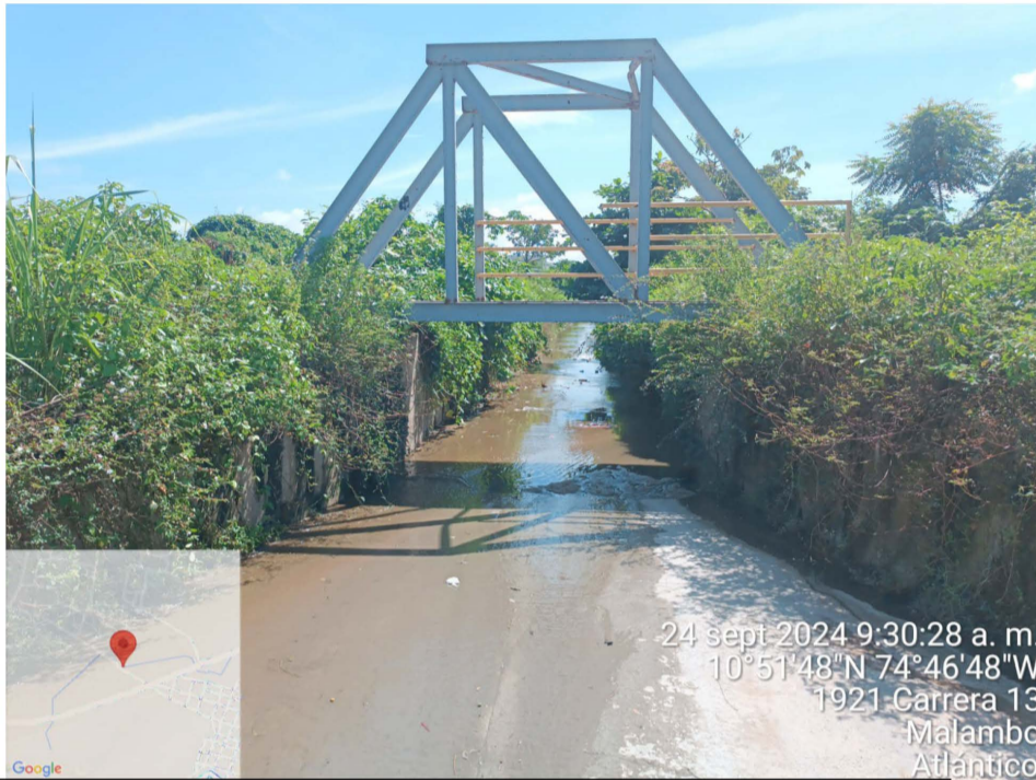
Foto N° 3 Fecha: 24 de septiembre del 2024. Ubicación: Canalización arroyo el Sapo, Malambo Atlántico Observaciones: Tramo con presencia de material vegetal en orillas del Arroyo.
