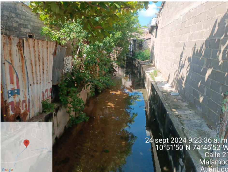
Foto N° 2 Fecha: 24 de septiembre del 2024. Ubicación: Canalización arroyo el Sapo, Malambo Atlántico Observaciones: canalización del arroyo el Sapo en normal funcionamiento
