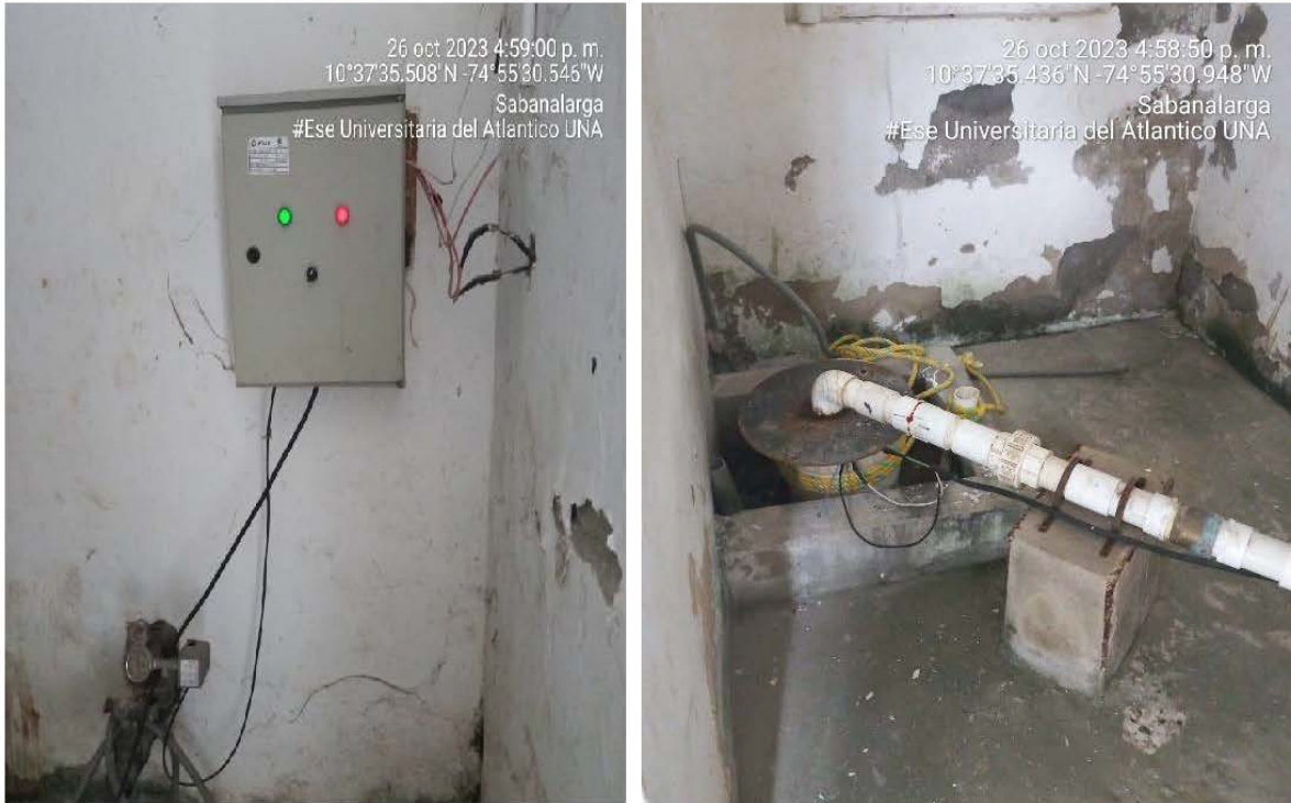
Imagen 11 – Pozo profundo para captar aguas subterráneas - ESE UNIVERSITARIA DEL ATLANTICO SEDE CACR SABANALARGA, con su respectivo medidor de caudal. Coordenada 10^{\circ}37'35.436''N 74^{\circ}55'30.948''W
