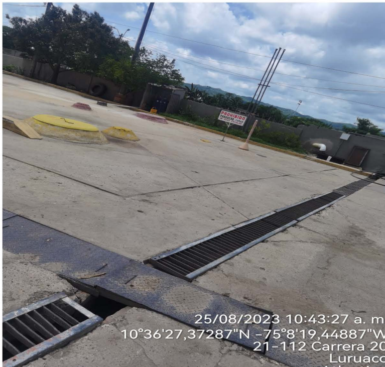
Dique de contención del área de tanques subterráneos y rejillas para el manejo de escorrentías.
